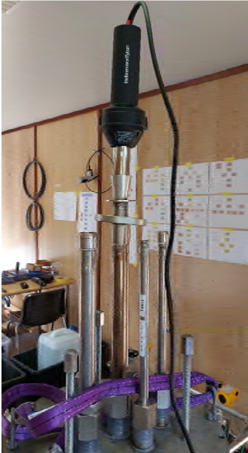
KUVA 23. Reaktorin uusi lämmityslinja asennettuna.
