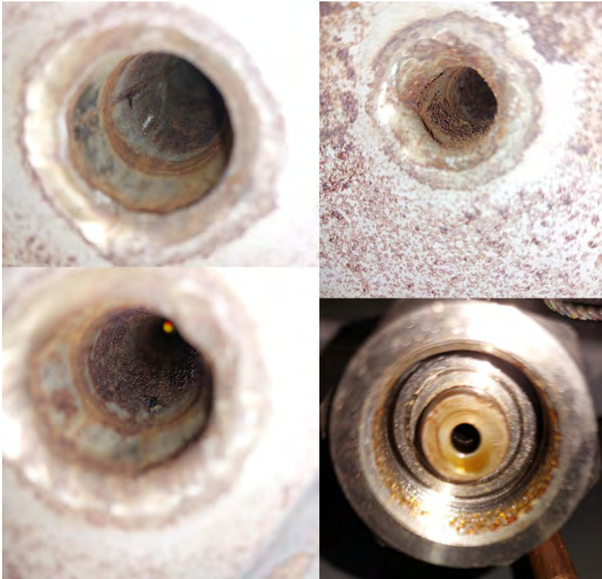
KUVA 32. Kloorin aiheuttamaa korroosiota eri puolilla reaktorin linjoja.
